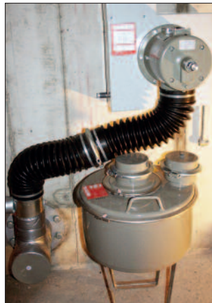
Gasfilter und Schutzraumventilator.
