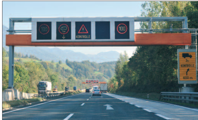
Verkehrsbeeinflussungsanlage auf der A12 bei Wörgl.
