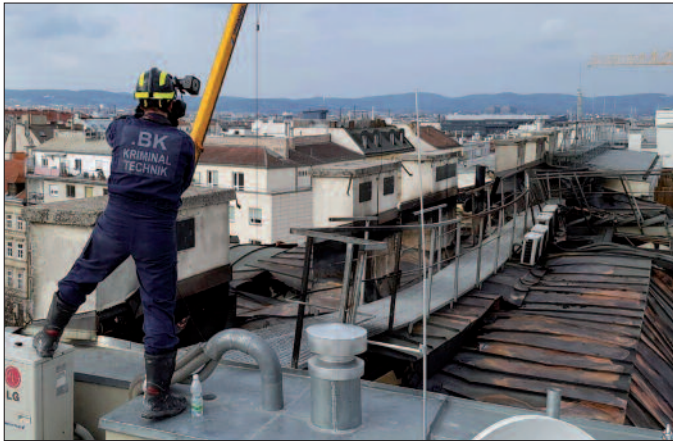
Brandursachenermittlung: Dokumentation eines Dachstuhlbrandes in Wien durch einen Kriminaltechniker.
