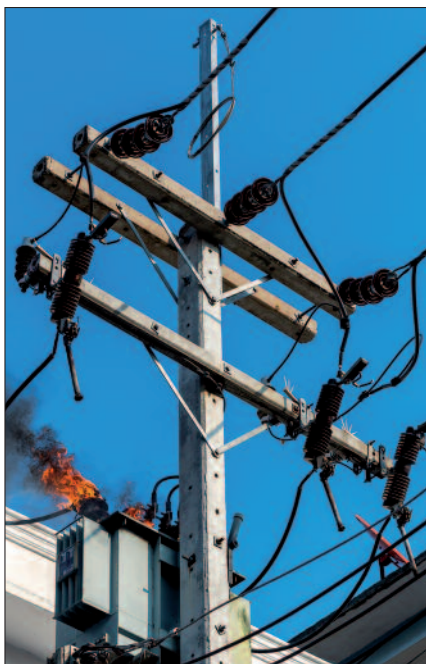
Ein technisches Gebrechen kann zu längerfristigem Stromausfall führen.
