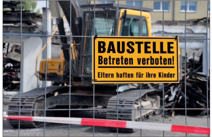
Baustellensicherung: Zäune oder Video- und Alarmanlagen können den Schutz erhöhen und abschrecken.
